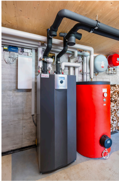
Mit einem Energiemanagementsystem (oben links) kann der Eigenverbrauch in den meisten Fällen deutlich gesteigert werden.
